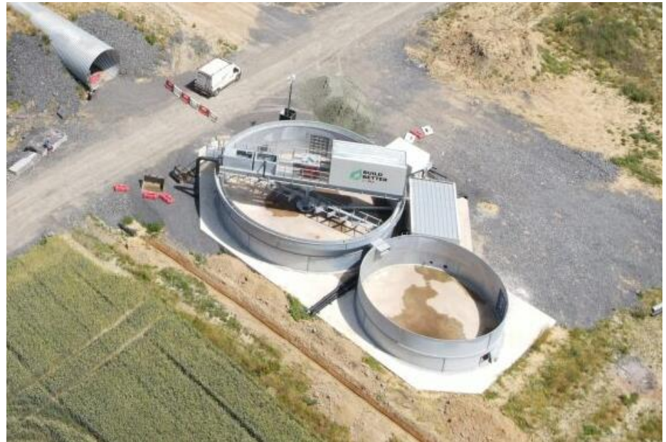
Réutilisation en circuit fermé via un clarificateur. Recyclage des eaux à 650m 3 /h
